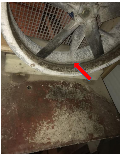
Figuur 3: – Ventilator met los materiaal en CIPC residuen.
